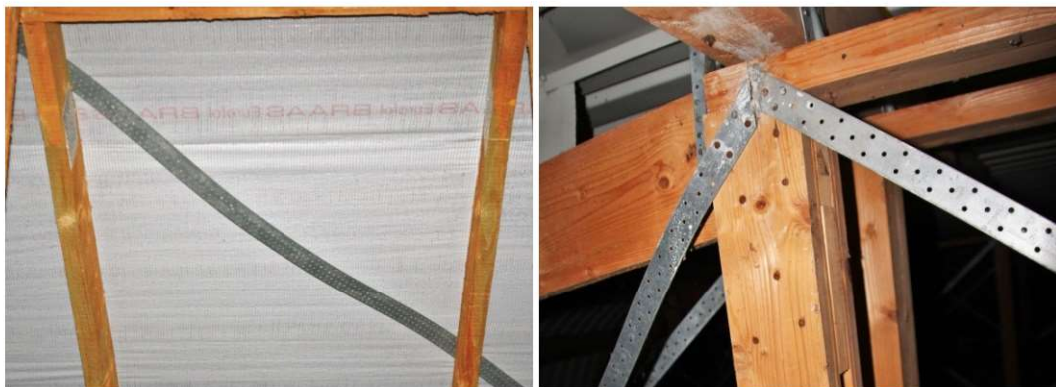
Fot. 7.19 NIE. Przypadkowe wykonanie stężeń z zastosowaniem taśmy perforowanej. Po lewej stronie wyraźne obwiśnięcie taśmy, co powoduje, że nie spełnia żadnej roli jako stężenie, po prawej stronie przypadkowe, niczego nie gwarantujące zamocowanie taśmy na elemencie drewnianym (fot. E. I. Kotwica)
