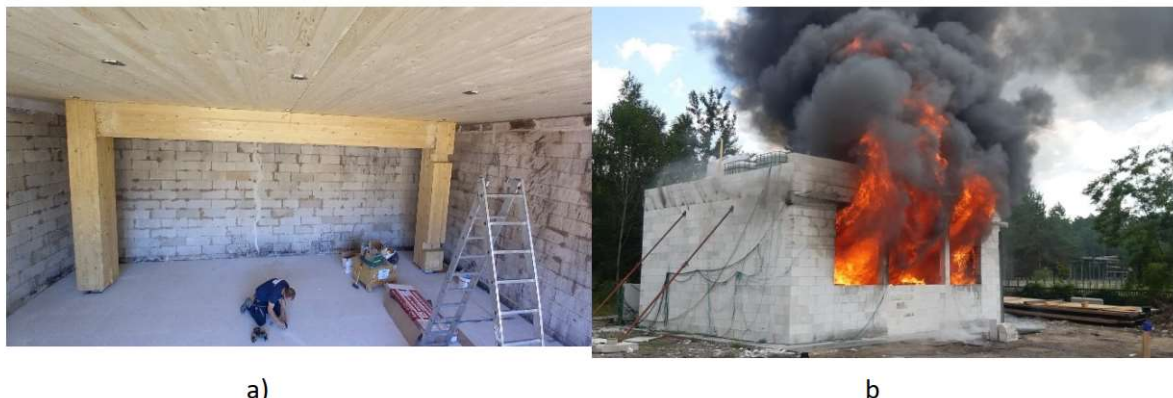
Fot. 6.22. Konstrukcja z drewna klejonego w skali rzeczywistej: a) w trakcie przygotowań, b) w trakcie pożaru o dużym obciążeniu ogniowym. (fot. P. Sulik)
