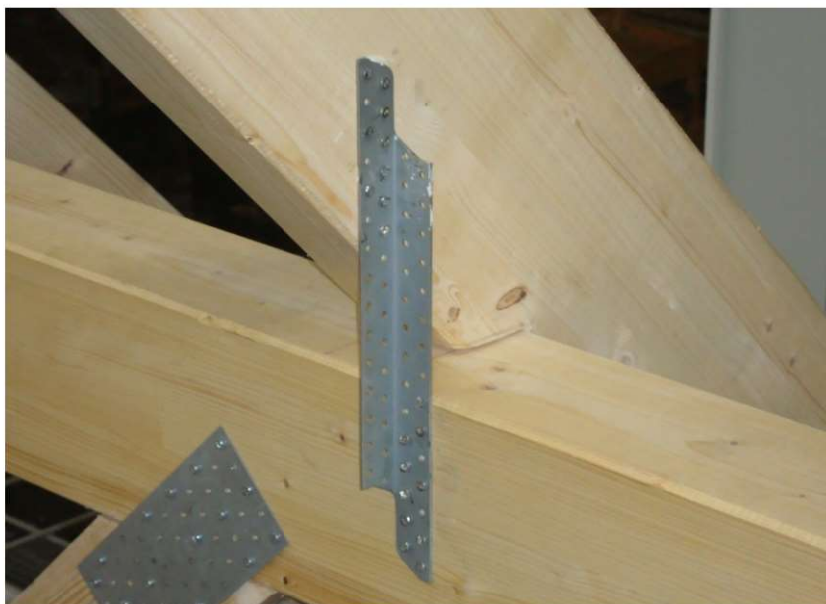
Fot. 7.24 TAK. Poprawnie wykonane połączenia z wykorzystaniem tącznika krokwiowego projektowo dobranej ilości tączników. (fot. T. Szczesiak)
