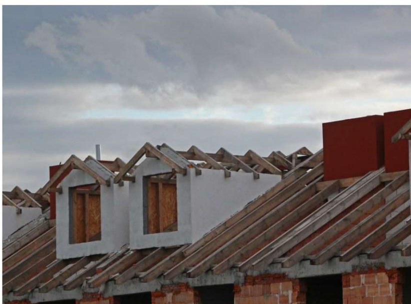
Fot. 5.3 Więźba dachowa niszcząca od wielu miesięcy bez pokrycia. Stan części elementów już obecnie wskazuje na konieczność wymiany (fot. E. I. Kotwica)
