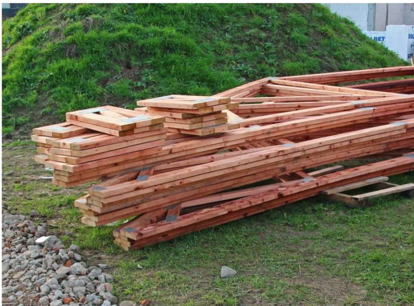
Fot. 5.2 Niepoprawne składowanie wiązarów prefabrykowanych – zarówno z punktu widzenia odległości od podłoża, jak i braku odpowiednio rozmieszczonych podpór, co skutkuje niekontrolowanymi deformacjami wiązarów. (fot. E. I. Kotwica)
