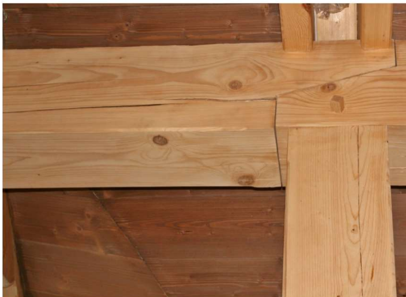
Fot. 7.11 Zastosowanie drewna nie przeznaczonego do celów konstrukcyjnych w połączeniu z przyjętym rozwiązaniem (nie wiadomo, czy przez projektanta, czy „pomysłowego” wykonawcę) zaskutkowało spękaniem i brakiem pracy części odspojonej. Niezbędne wzmocnienie. (fot. E. I. Kotwica)
