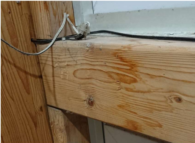
Fot.7.18. Nieszczelność obudowy powoduje zawilgocenie drewnianych elementów konstrukcyjnych i docelowo ich korozję biologiczną (fot. E. I. Kotwica)
