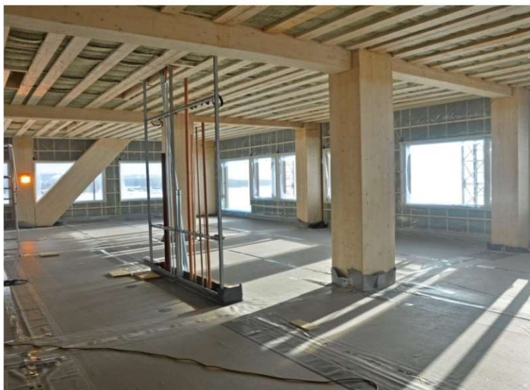
Fot.1. 13. 18-kondygnacyjny budynek Mjøstårnet w Brumunddal na etapie montażu (fot. T. Birgersson)
