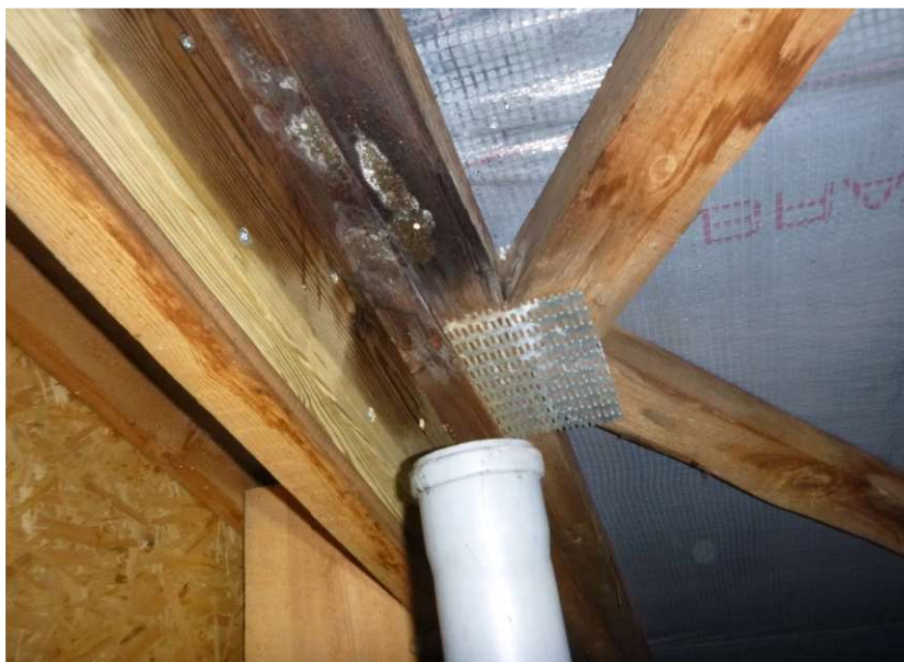
Fot. 7.15 Wskutek kolizji wywiewki kanalizacji z elementem konstrukcji, zakończono rurę pod elementem drewnianym, czego efektem jest widoczna na zdjęciu korozja biologiczna elementu drewnianego (fot. U. Kotwica)
