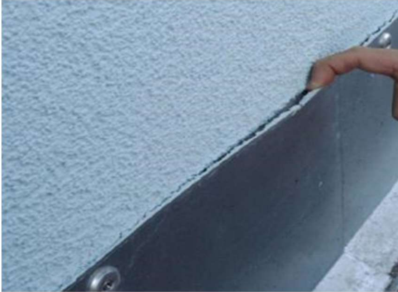
Fot.7.17 Niepoprawnie wykonana obróbka – z pominięciem systemowego profilu przejściowego. (fot. z archiwum Stowarzyszenia EDG)
