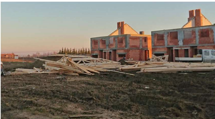
Fot. 7.8 Niepoprawny sposób składowania więzów kratowych i drewna – elementy konstrukcyjne leżą w sposób przypadkowy, w bezpośrednim kontakcie z gruntem. (fot. E.I. Kotwica)
