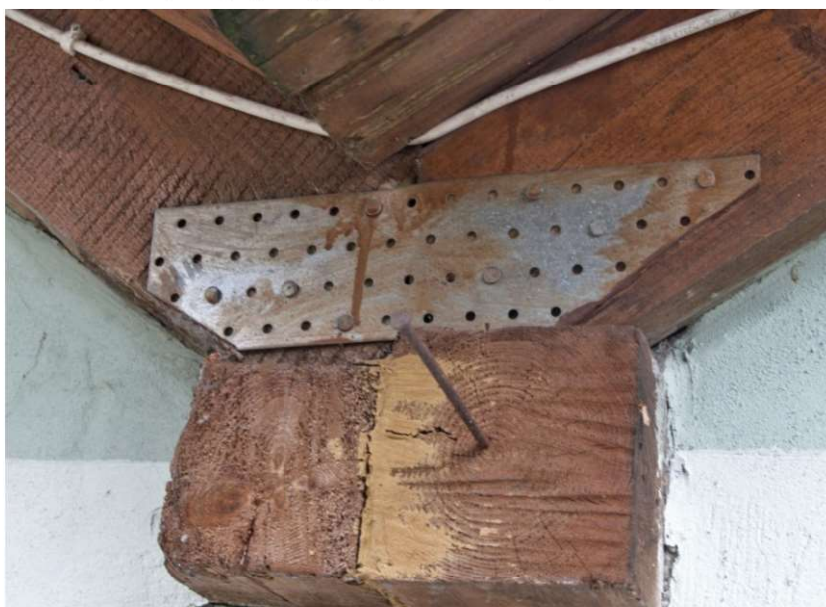
Fot. 7.10 Detal połączenia wykonany według fantazji wykonawcy. Przypadkowe rozmieszczenie i przypadkowa ilość łączników, przypadkowe wymiary elementów konstrukcji drewnianej (fot. E. I. Kotwica)
