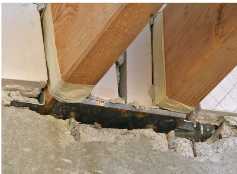
Fot. 7.12 Przypadkowe i niestaranne wykonanie połączenia na podporze. (fot. E. I. Kotwica)
