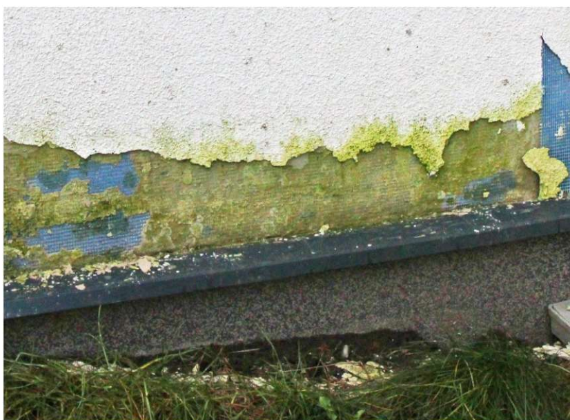
Fot.7.16 Niepoprawnie zaprojektowany i wykonany detal połączenia ściany budynku ze ścianą fundamentową – wykonanie cokółu wystającego poza lico ściany skutkuje zaleganiem wody i korozją w obrębie ściany, cokół jest też za niski (fot. E.I. Kotwica)
