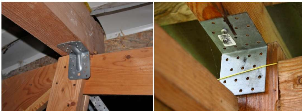
Fot. 7.21 NIE. Niepoprawne, przypadkowe zamocowanie kątowników. Po lewej stronie zastosowano losowo dobraną i rozmieszczoną liczbę łączników, dodatkowo niepoprawnie sytuując kątownik. Po prawej stronie połączenie wygląda tak, jakby właśnie wykonawcy skończyły się gwoździe i wkręty... (fot. E. I. Kotwica)
