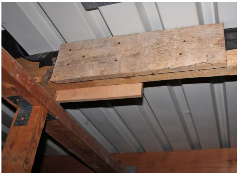
Fot. 7.13 Przypadkowe i niestaranne wykonanie połączenia styku. (fot. E. I. Kotwica)
