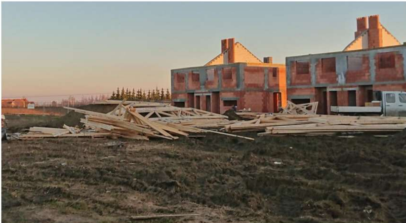
Fot. 7.8 Niepoprawny sposób składowania wiązarów kratowych i drewna – elementy konstrukcyjne leżą w sposób przypadkowy, w bezpośrednim kontakcie z gruntem. (fot. E.I. Kotwica)
