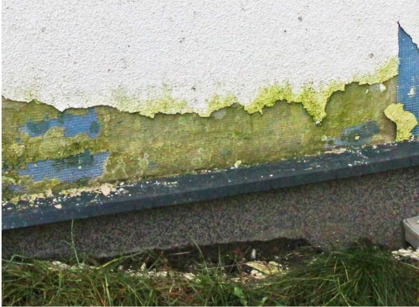
Fot.7.19 Niepoprawnie zaprojektowany i wykonany detal połączenia ściany budynku ze ścianą fundamentową – wykonanie cokołu wystającego poza lico ściany skutkuje zaleganiem wody i korozją w obrębie ściany, cokół jest też za niski (fot. E.I. Kotwica)
