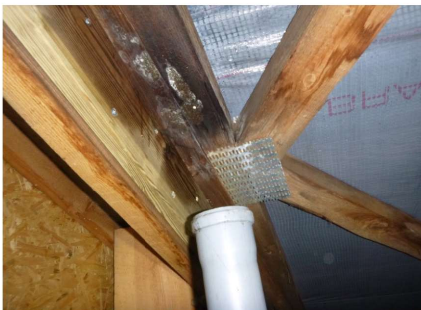
Fot. 7.18 Wskutek kolizji wywiewki kanalizacji z elementem konstrukcji, zakończono rurę pod elementem drewnianym, czego efektem jest widoczna na zdjęciu korozja biologiczna elementu drewnianego (fot. U. Kotwica)
