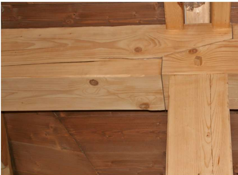
Fot. 7.12 Zastosowanie drewna nie-przeznaczonego do celów konstrukcyjnych w połączeniu z przyjętym rozwiązaniem (nie wiadomo, czy przez projektanta, czy „pomysłowego” wykonawcę) zaskutkowało spękaniem i brakiem pracy części odspojonej. Niezbędne wzmocnienie. (fot. E. I. Kotwica)
