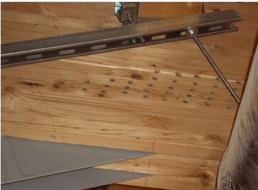
Fot. 4.9 Błędne mocowanie ściągu skutkujące spękaniami w osi ostatnich łączników (fot. R. Orłowicz)
