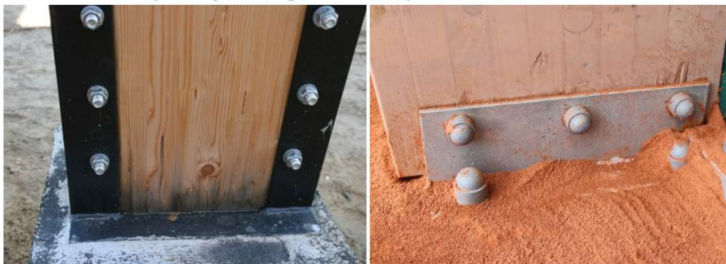
Fot. 7.28 NIE. Niepoprawne wykonstruowanie i wykonanie podpór słupów. Usytuowanie drewna w bezpośrednim sąsiedztwie wilgotnego podłoża skutkuje podciąganiem kapilarnym wody, a docelowo – korozją biologiczną (fot. E. I. Kotwica)
