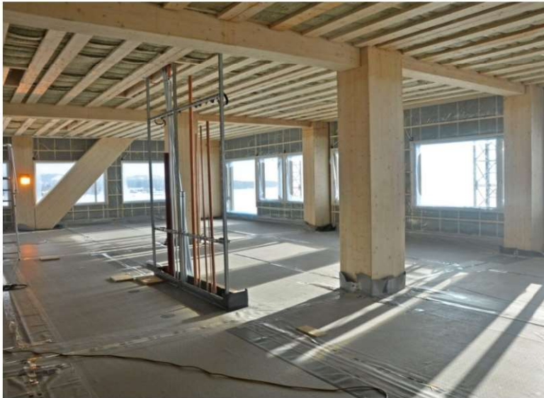
Fot.5.11. 18-kondygnacyjny budynek Mjøstårnet w Brumunddal na etapie montażu (fot. T. Birgersson)
