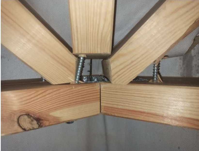
Fot. 7.11 Detal połączenia wykonany według fantazji wykonawcy.(fot. P. Sulik)
