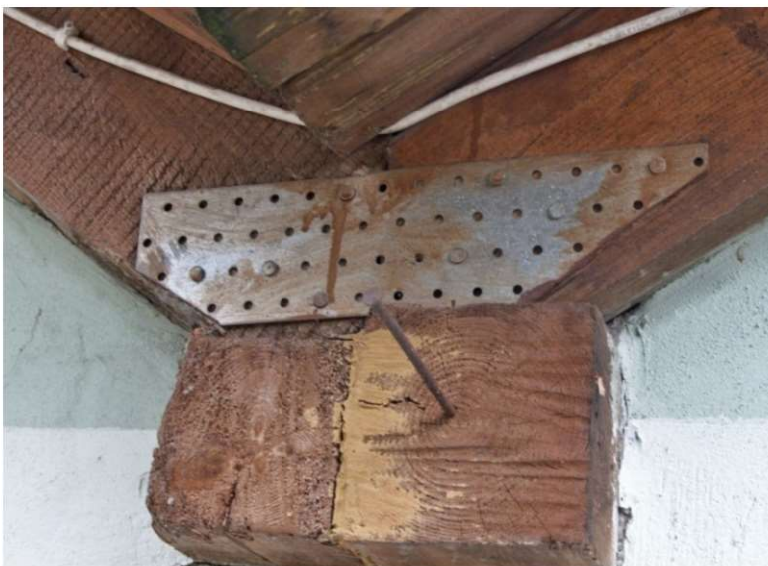
Fot. 7.10 Detal połączenia wykonany według fantazji wykonawcy. Przypadkowe rozmieszczenie i przypadkowa ilość łączników, przypadkowe wymiary elementów konstrukcji drewnianej (fot. E. I. Kotwica)
