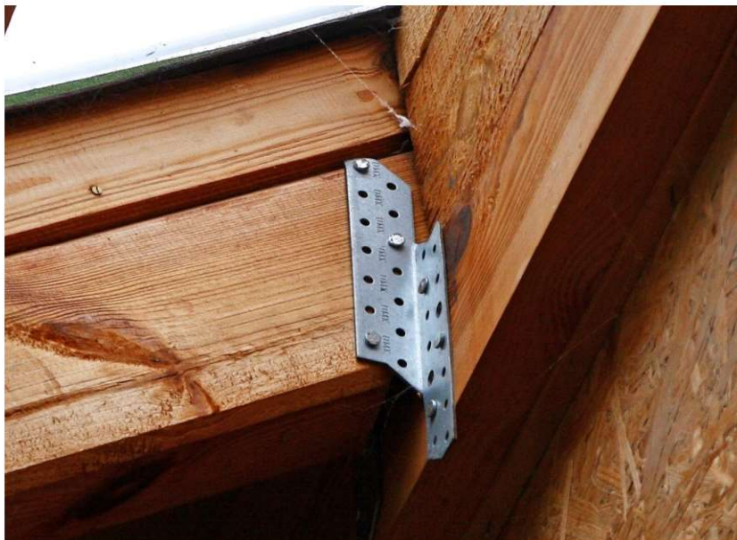
Fot. 7.26 NIE. Niepoprawne, przypadkowe zamocowanie łącznika krokwiowego (fot. E. I. Kotwica)
