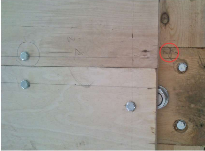
Fot. 7.15 Brak zachowania normowych odległości od krawędzi łączonego materiału. Na czerwono zaznaczono odległość osi łącznika od krawędzi elementu drewnianego – mniejszą niż wymagana normowo (fot. E. I. Kotwica)
