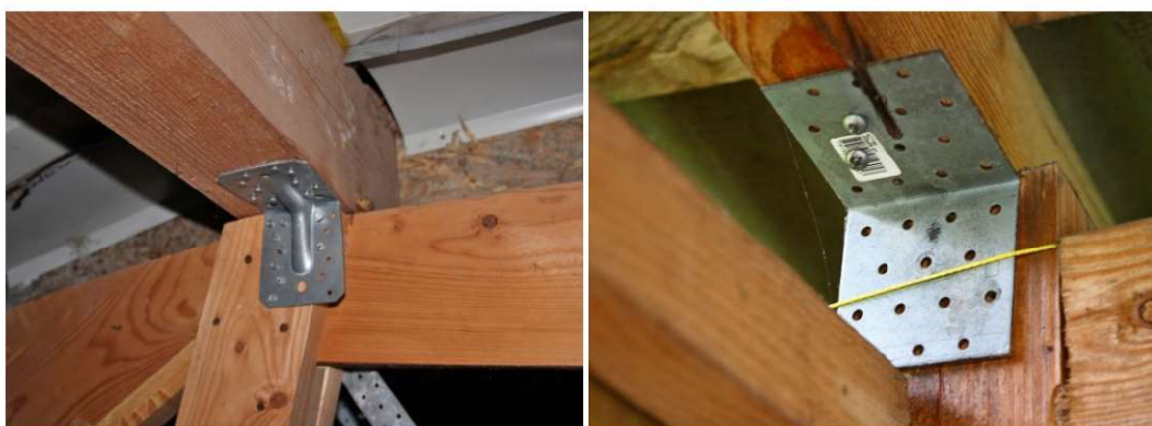
Fot. 7.24 NIE. Niepoprawne, przypadkowe zamocowanie kątowników. Po lewej stronie zastosowano losowo dobraną i rozmieszczoną liczbę łączników, dodatkowo niepoprawnie sytuując kątownik. Po prawej stronie połączenie wygląda tak, jakby właśnie wykonawcy skończyły się gwoździe i wkręty. (fot. E. I. Kotwica)
