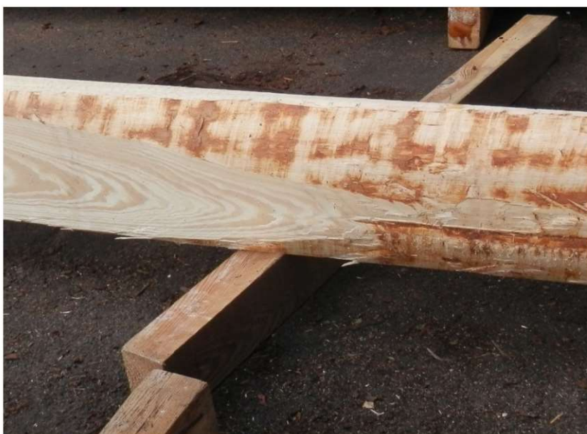
Fot. 7.6 Element z drewna litego, który nie nadaje się do zastosowania konstrukcyjnego (fot. E. I. Kotwica)
