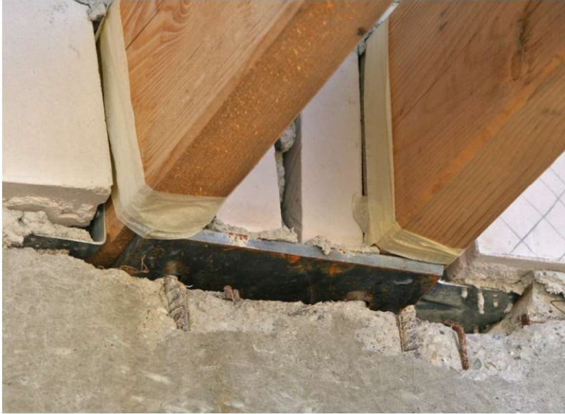
Fot. 7.13 Przypadkowe i niestaranne wykonanie połączenia na podporze. (fot. E. I. Kotwica)
