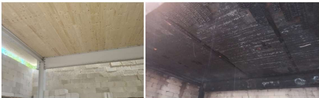
Fot. 6.11. Widok obciążonego stropu z drewna klejonego przed i po ponad 2 godzinnym w pełni rozwiniętym pożarze (fot. P. Sulik)
