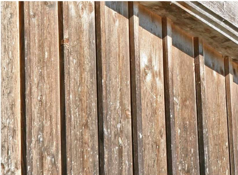
Fot. 4.1 Widok przebarwionej elewacji drewnianej (fot. E. I. Kotwica)
