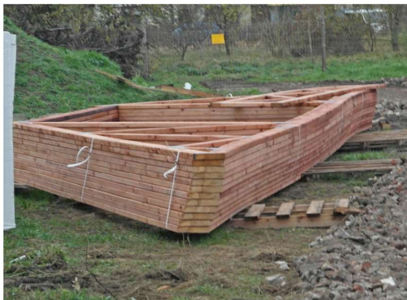
Fot. 4.1 Niepoprawny sposób składowania więźarów kratowych – widoczne odkształcenia spowodowane nierównościami podparć oraz zbyt bliska odległość od ziemi. (fot. E.I. Kotwica)
