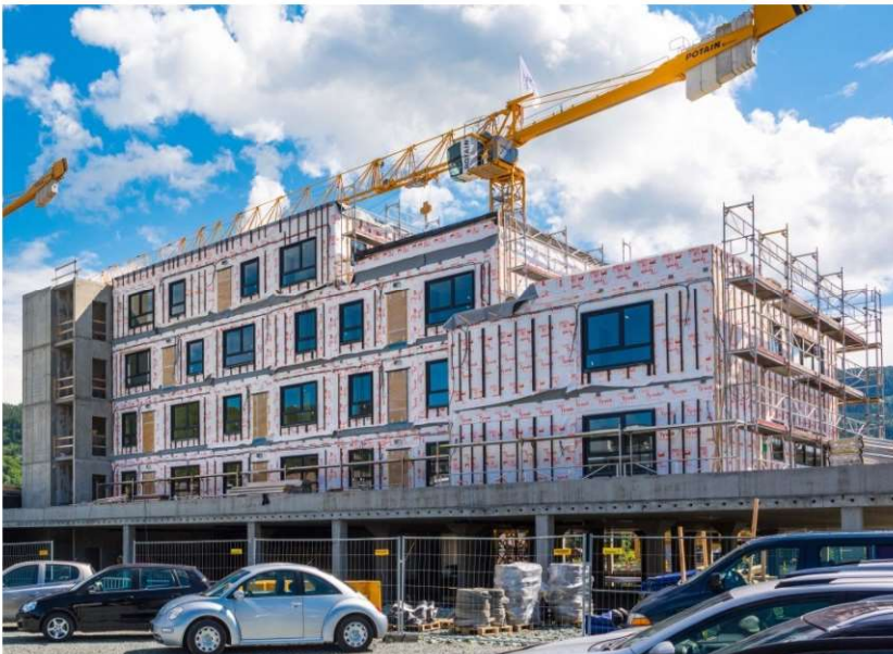
Fot. 1.10 Montaż modułowego budynku wielorodzinnego przez polskiego producenta w Norwegii (fot. Z archiwum Stowarzyszenia Energooszczędne Domy Gotowe)
