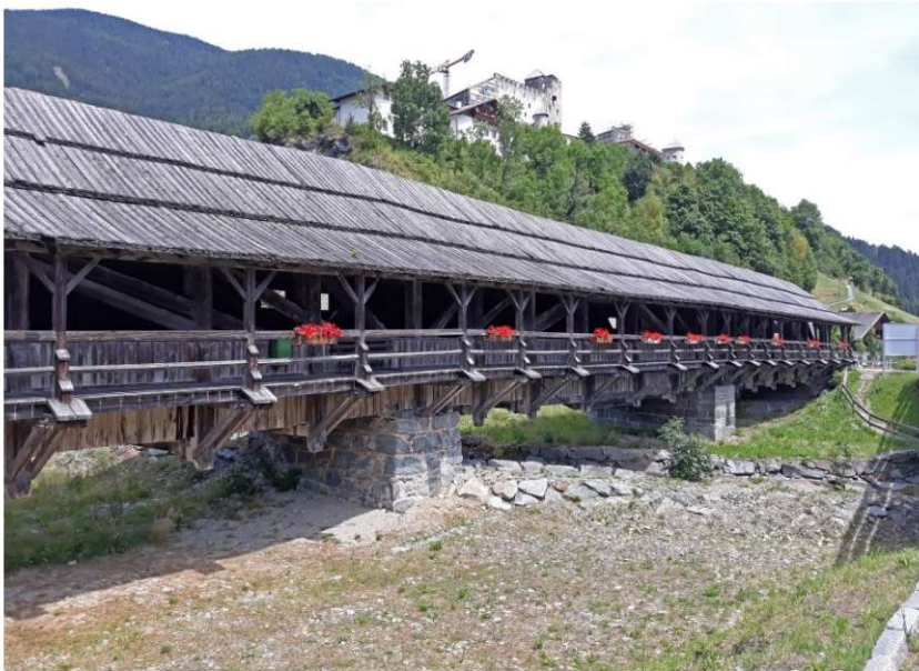
Fot. 1.6. Drewniany most z 1781 roku o całkowitej długości 66 m, Austria, Panzerdorf (fot. P. Sulik)
