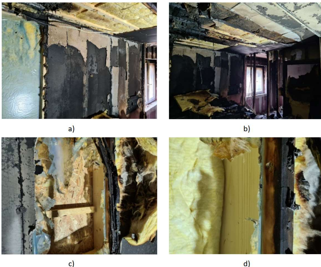
Fot. 6.12. Scenariusz pożarowy P3 – widok pomieszczenia po pożarze: a) ściana z odsłoniętymi kolejnymi warstwami, b) strop z odsłoniętymi kolejnymi warstwami, c i d) – widok odsłoniętej, nienaruszonej konstrukcji drewnianej ściany szkieletowej. (fot. P. Sulik)
